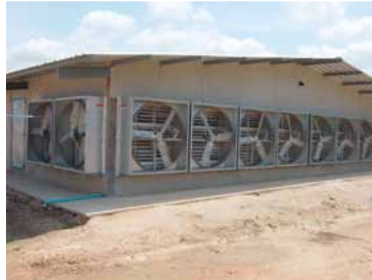
Рис 4.3: Пример автоматической вентиляции
